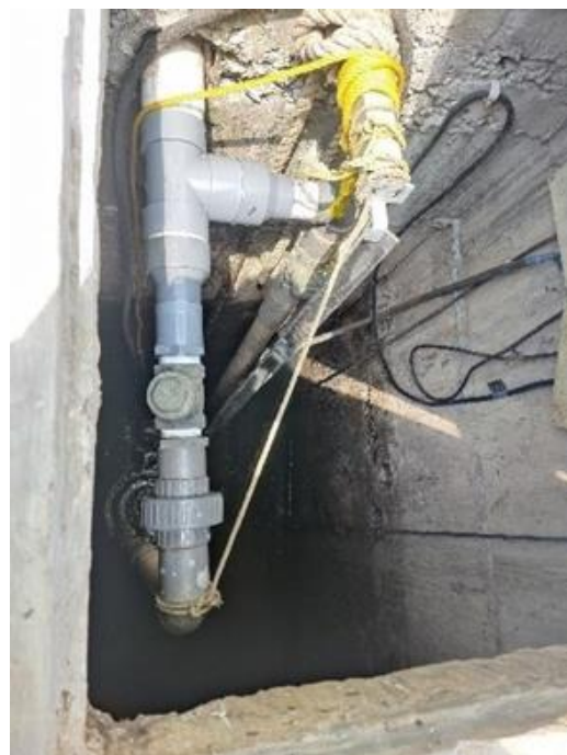
Gambar 5. Pompa Unit Sumur Pengumpul
