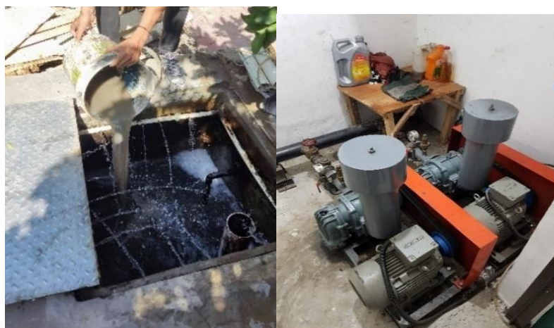
Gambar 11. Kolam Aerasi dan Blower
